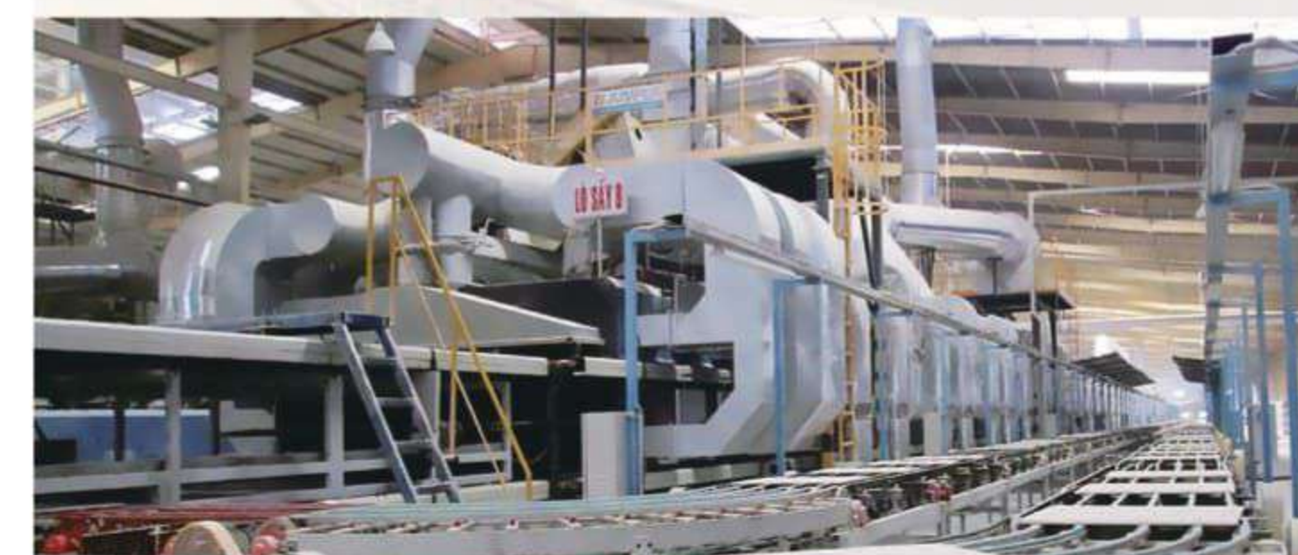
Heat Recycle System / 熱能回收系統
